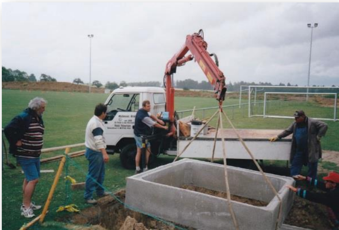
Auf dem Bolzplatz wurde der Tank für die Beregnungsanlage sowie die Steuerung eingebaut
